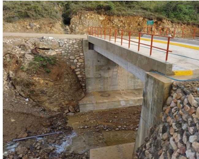
PUENTE RESBALOSO S/ 956,290.94 CONCLUIDA AL 100%
